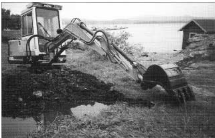
Tidligere i høst ble store deler av Oksvalstranda gravd opp. Svein Kaarød i kommunen lover at alt skal være i orden igjen når badesesongen starter
